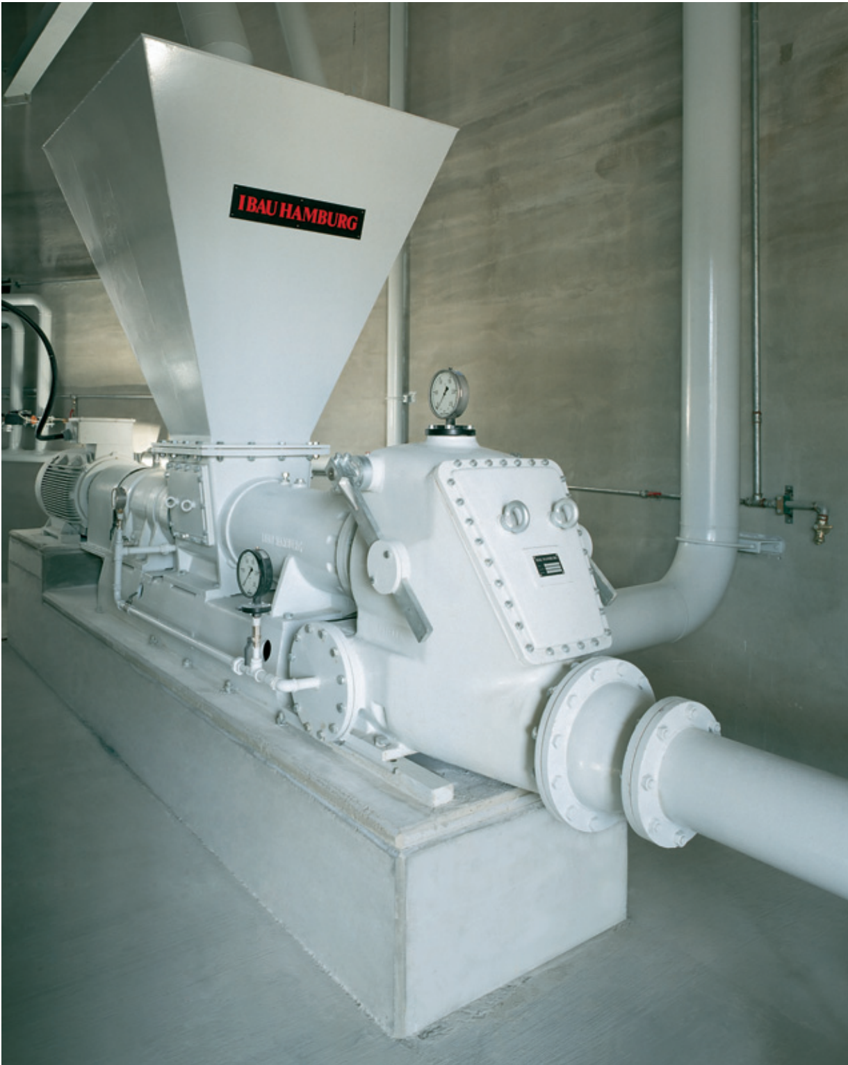
Fertigguttransport mit IBAU Schneckenpumpe
