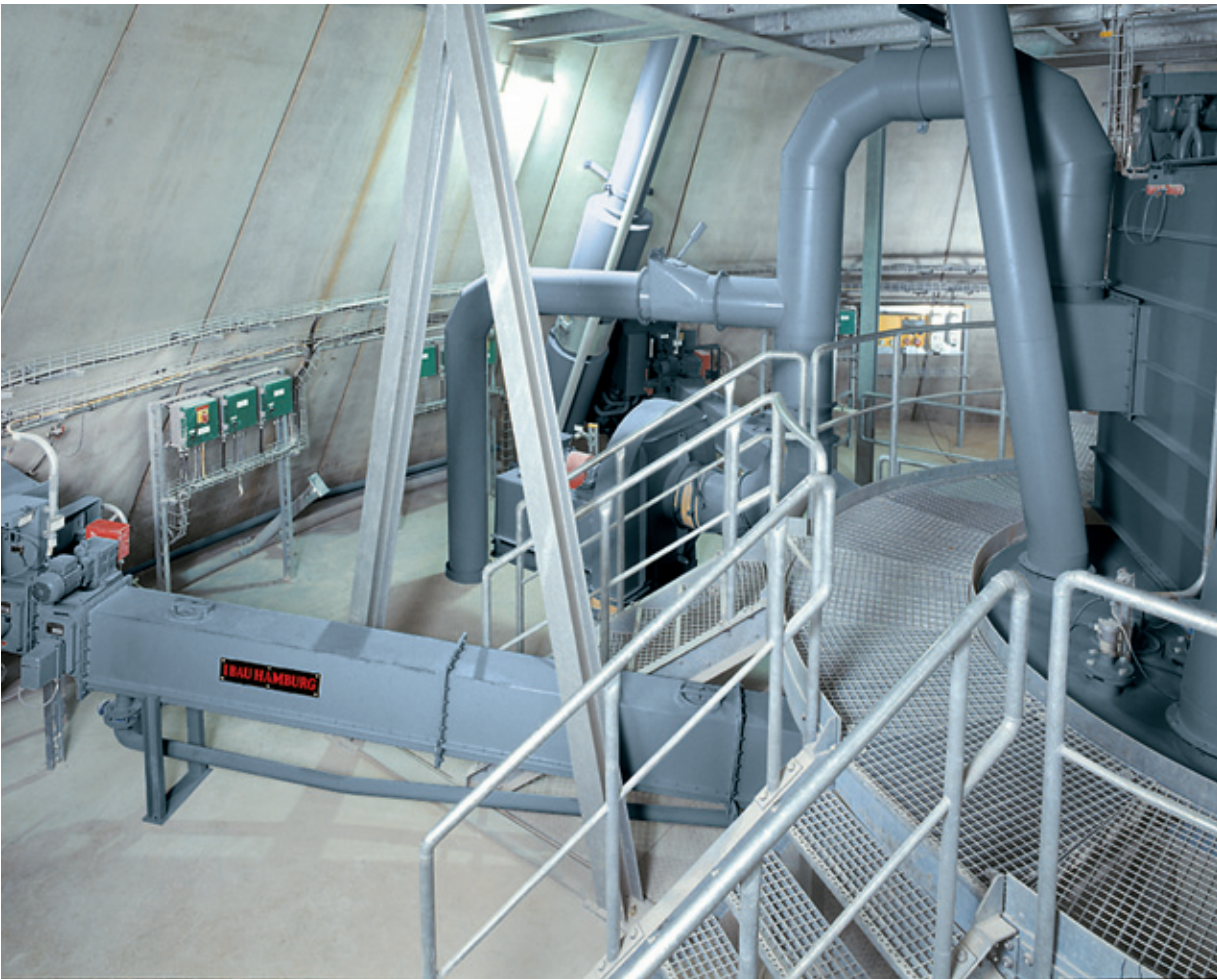
Siloabzug mit IBAU Dosierschieber
