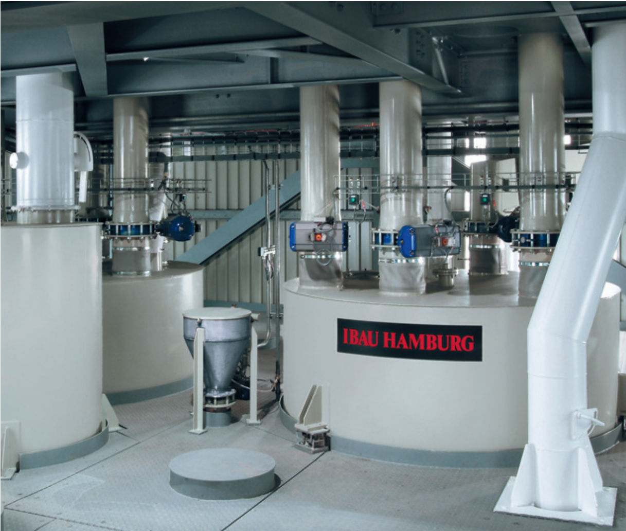
Beschickung über bis zu 4 Behälterwaagen für Chargen-Mischanlage
