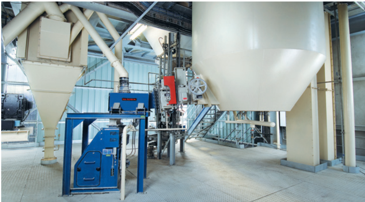
Kalibrierbehälter mit Durchlaufmessgerät
