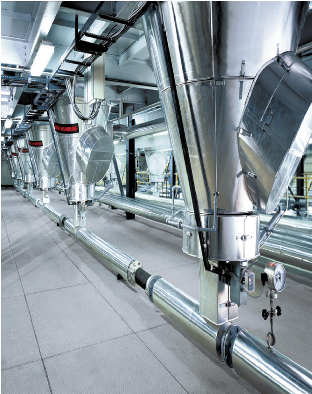
IBAU Druckgefäße im Kraftwerk Litvinov
